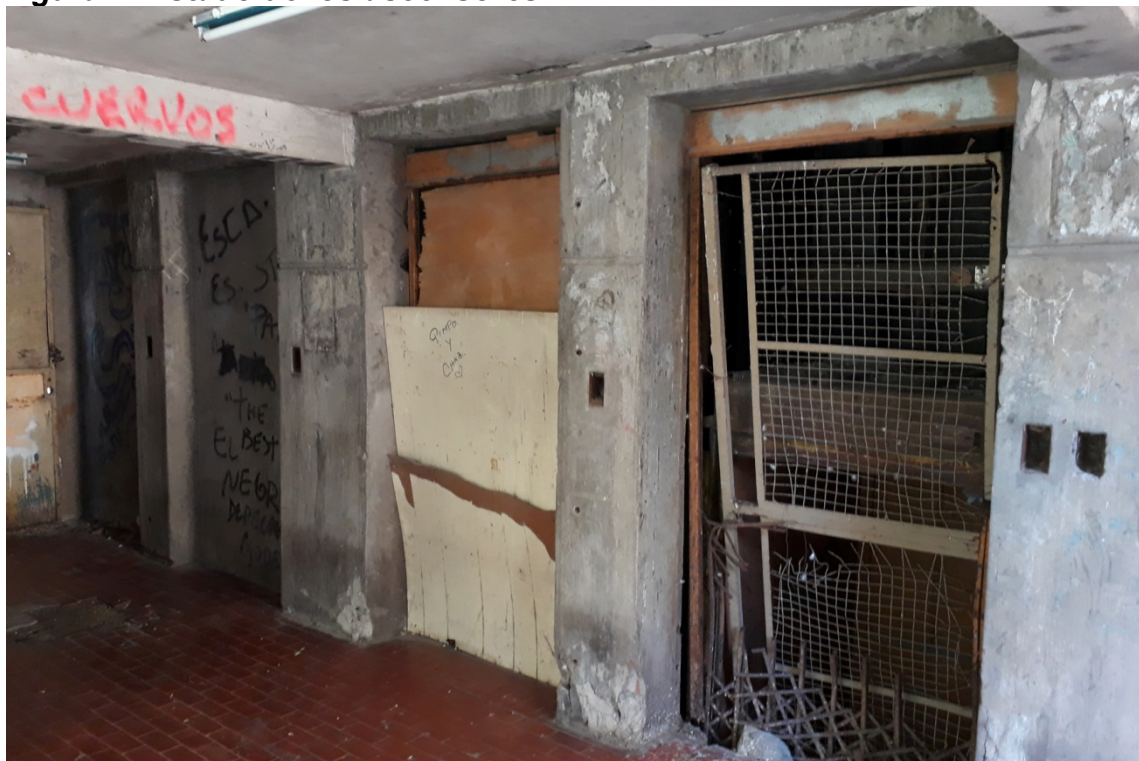
Figura 4: Estado de los ascensores.
