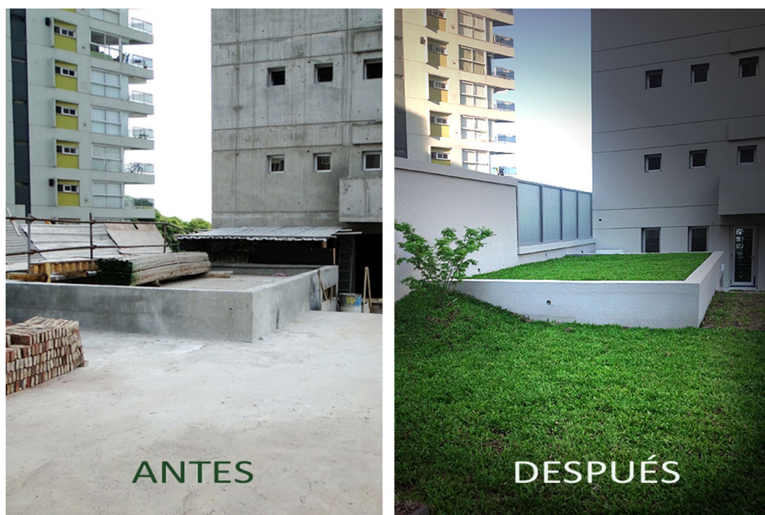
Figura 1. Antes y después en techos planos, 6º piso, uso: solarium y recreación. Losas sobre cocheras del edificio. Terrazas Verdes transitables, césped y plantas individuales, espesor de sustrato de 10 a 80 cm, riego automatizado, Rosario, 2012.
