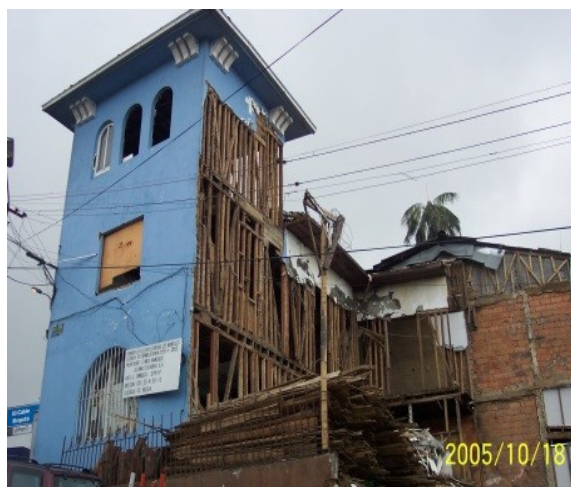
Figura 12: Bahareque de Transición Clínica Manizales. 1946. Demolida.
