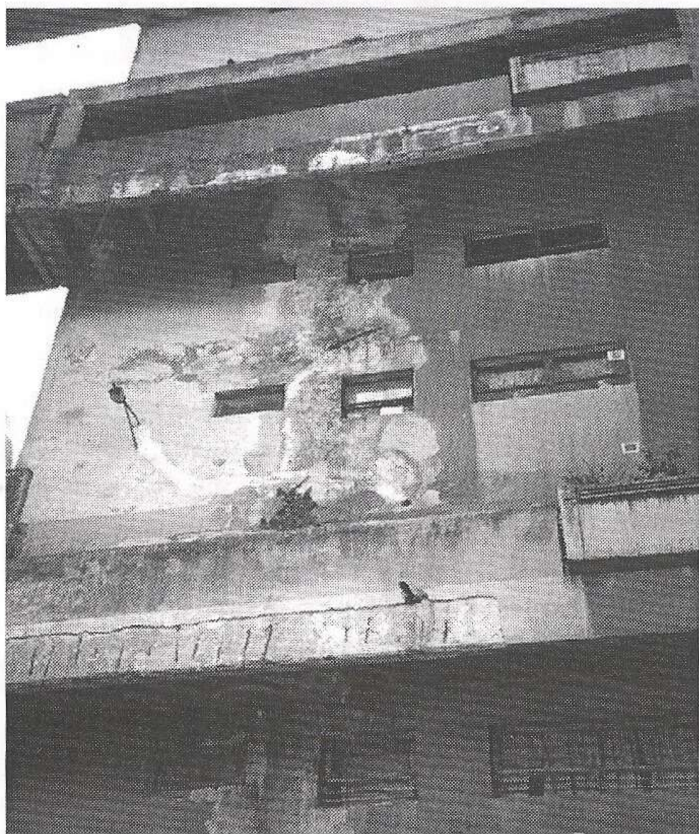
Figura 16. Filtraciones por pérdidas de cañerías de agua.
