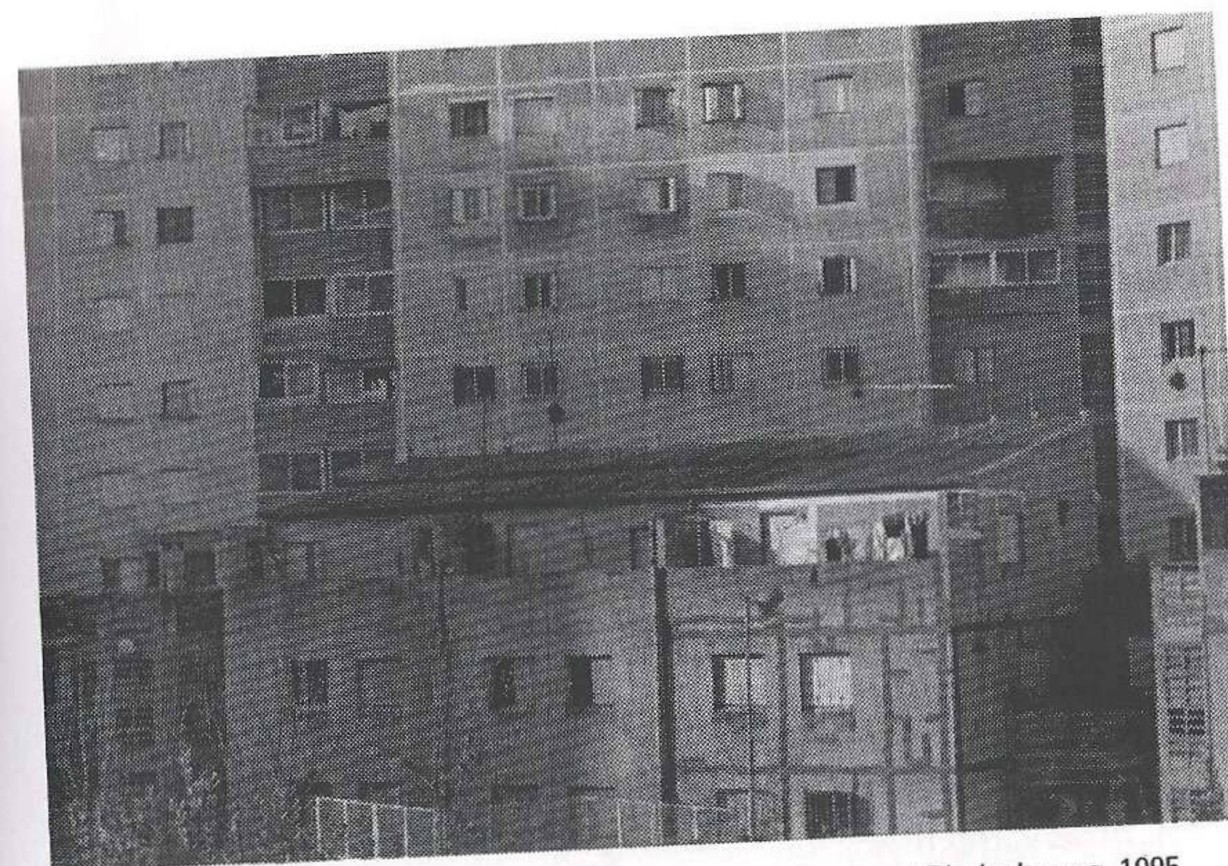
Figura 12. Fallas de junta entre paneles. Conjunto Habitacional Piedrabuena, 1995.
